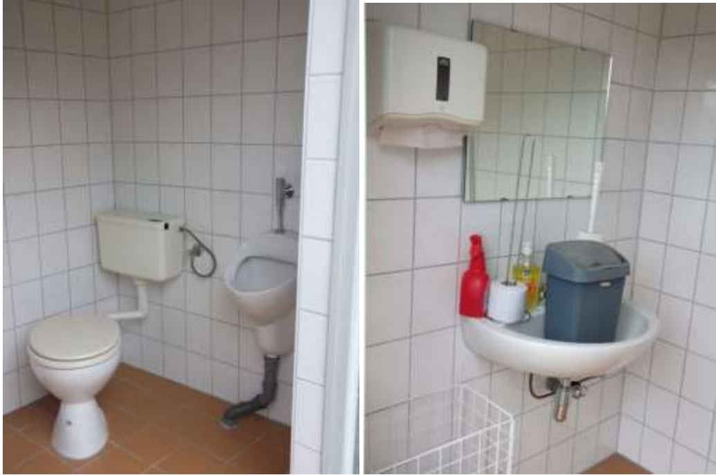
Toilette im Gerätehaus.
